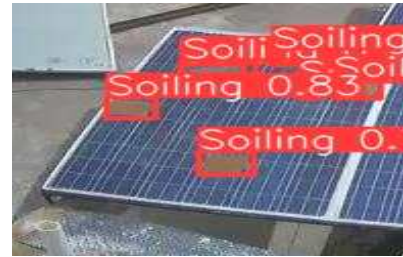
그림 5 실제 태양광 패널 오염물질 인식 테스트
